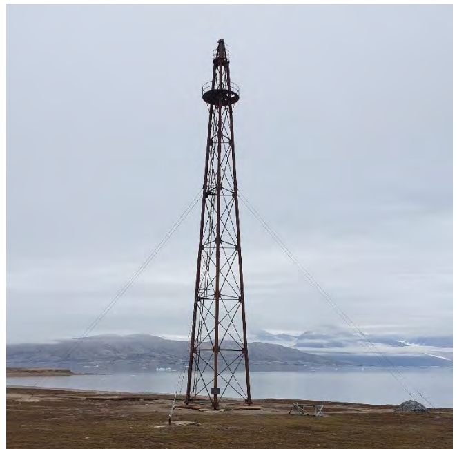
Figur 5. Luftskipmasta med nye barduner som ble montert des. 2021 (Foto Kings Bay AS, juli 2022)
