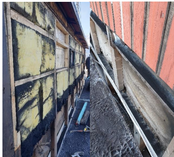
Viser gammel isolasjon og kledning på vestvegg.
