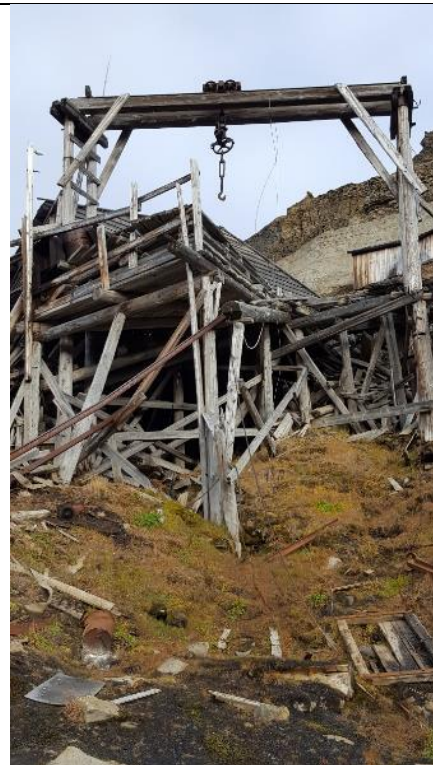
Bilde 6 Trekonstruksjon rundt plattform og kran på øverste nivå har fått alvorlige bruddskader.
