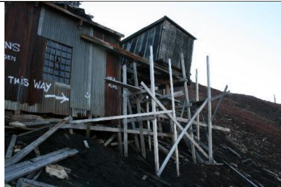
Bilde 7 Sørvestlig hjørne med ustabil konstruksjon som bør vurderes fjernet.
