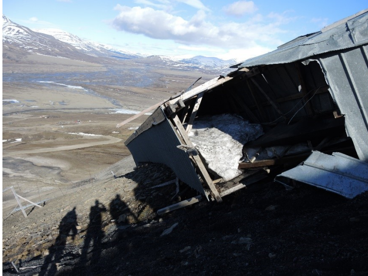
Overbygget fylt av snø og is – grunnen til at det ikke lot seg dra ned fra dalsiden
