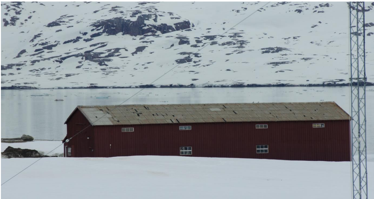
Figur 2 Jernlageret med de gamle takplatene av eternitt. Taket var lekk flere steder, og i generelt dårlig forfatning.
