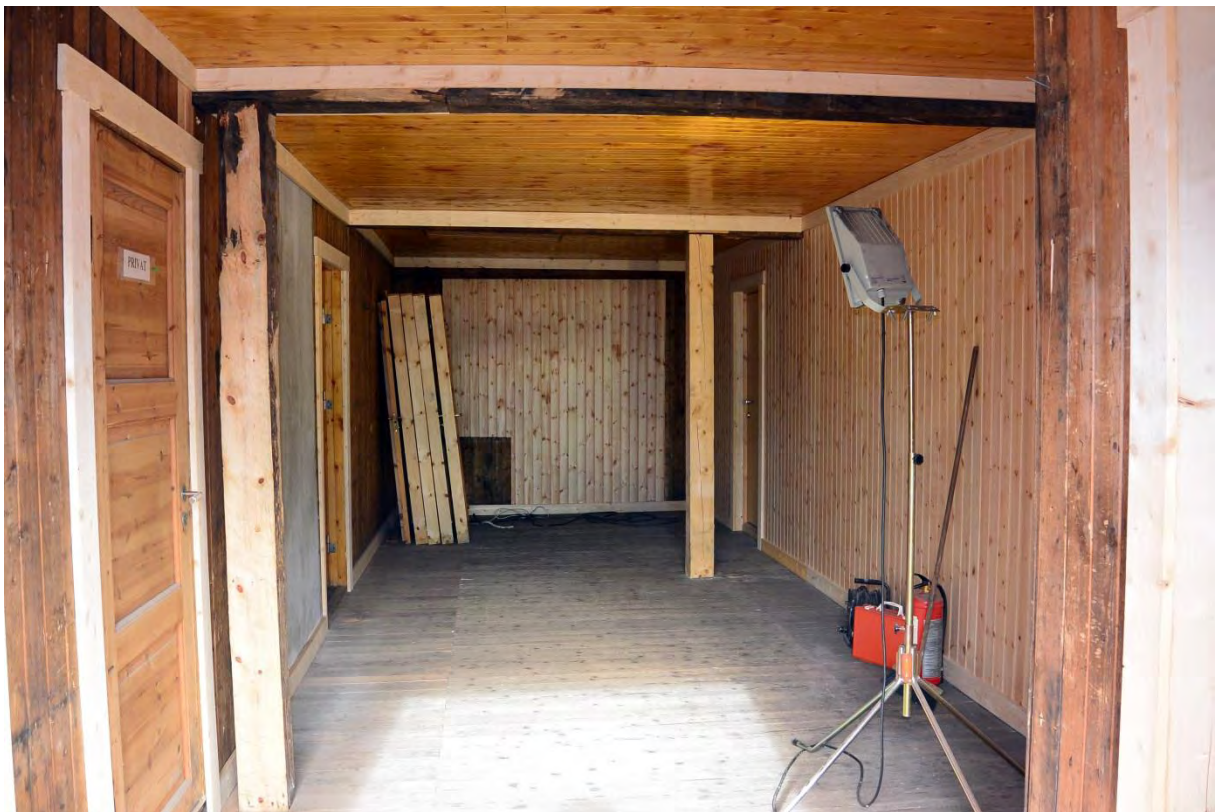
Fojeeen sett frå aust mot vest, med dør inn til trapp til venstre.
