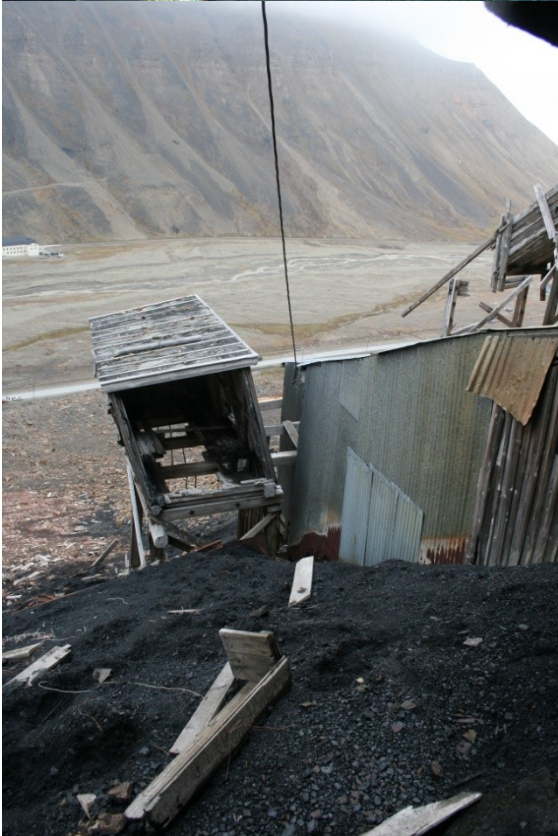
Heis(?)bu på tur. Se også rustskader i nedkant på blekkveggen. Her ble det krafset vekk masser i flere omganger alt etter at det tinte. Etterpå ble det lappet og laget med blikkplatebiter for å få veggen tett.
