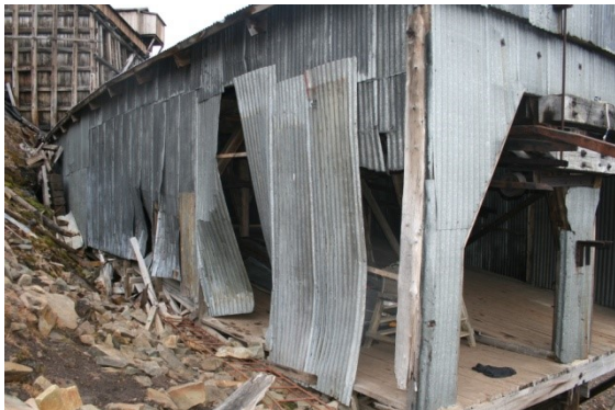
Nedre del av lasten med skader fra ras.
