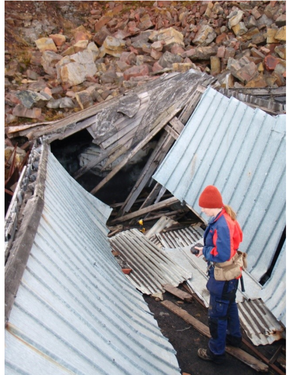
Tomvognstollen. Taket har kollapset på midten. Blikkplatene i god nok stand til å gjenbrukes. Johanna på bildet.
