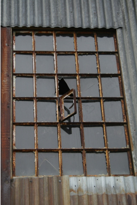
Skade i pleksiglass. Platen er utskiftet.
