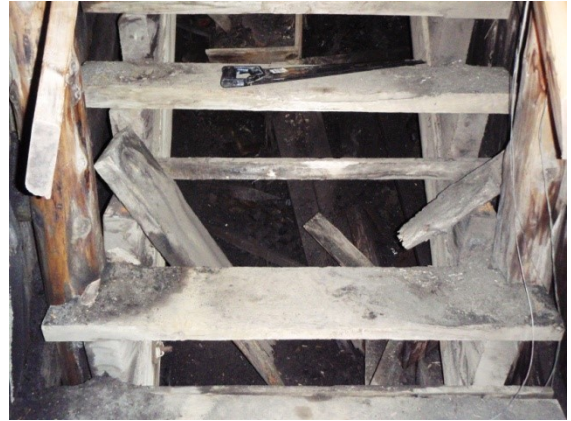
Slik så det ut på noen steder opp gjennom trappa. Det er fortsatt noen trinn som skulle vært skiftet- Materialer er bestilt og levert, og det er derfor mulighet til å ta det siste når det måtte passe.
