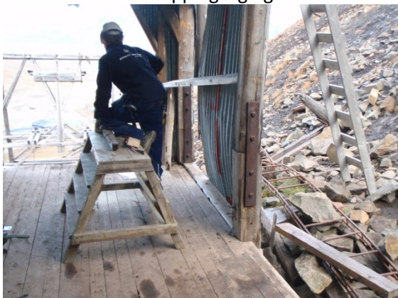
Nedre del av lasten. De fleste spikerslag var borte, noen sannsynligvis revet vekk for å bedre adkomst. Preben sager.
