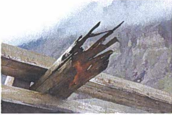
En av taubanebukkene til Gruve 2b ble slått overende av et snøras i januar i år. Taubanen fraktet kullet fra gruva og ned til utskipningskaia. Den bakenforliggende årsaken til at bukken ga etter var at bena var sterkt svekket av råte. Hele anlegget er automatisk fredet etter Svalbardmiljøloven. Foto: NIKU/Anne-Cathrine Flyen
