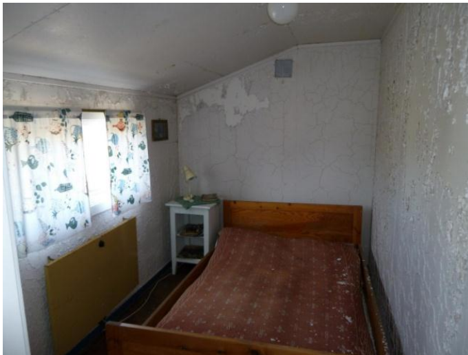
Museumshytta. Soverommet har det største problemet med flassende maling.
