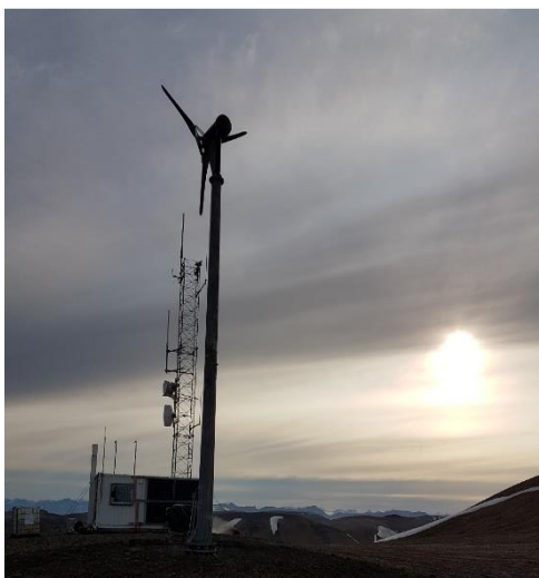
3 kW vindmølle montert på off-grid anlegg, Torfjell
